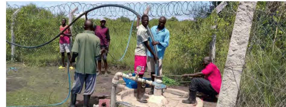
Wartung der Wasserpumpe: Verstopfte Filter müssen gereinigt oder defekte Dichtungen ausgetauscht werden.
